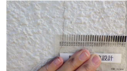
★ひび割れの確認の様子(ひび割れの幅：0.1mm) 0.3mm未満のひび割れは「軽微」と判断できます★
