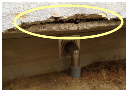
★コンクリート爆裂★
