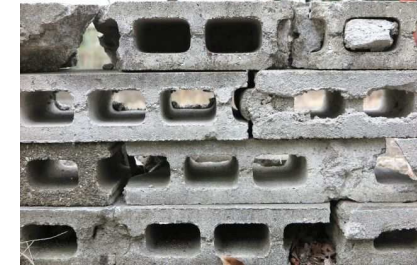
★老朽化したブロック★
