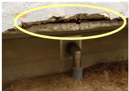
★コンクリート爆裂★
